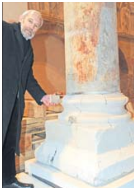
Säule Nummer 19 weist massive Schäden auf, wie Jürgen Götz in der Michaeliskirche beweist. Um den Schaft aus Bernwards Zeiten zu erhalten, muss die Beton-Basis ersetzt werden. Ein heikles Unternehmen.
